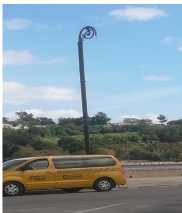
Luminaria rota, Avenida del Puerto, municipio Habana Vieja. Foto: ICLEP
