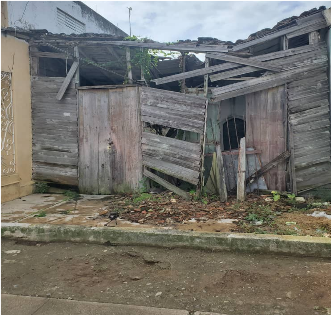
Los derrumbes de viviendas privadas cada vez se hacen más comunes en los barrios de la ciudad de Santa Clara
