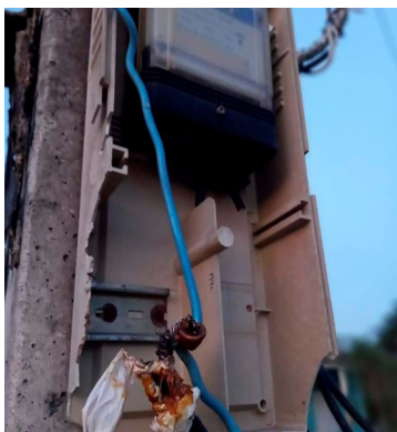
Contador eléctrico afectado. Foto: ICLEP
