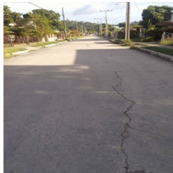
Carretera cerrada. Foto ICLEP
