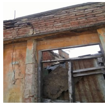
Vivienda afectada . Foto ICLEP
