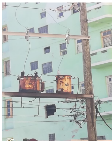
Transformadores en la calle Humboldt. Foto: ICLEP
