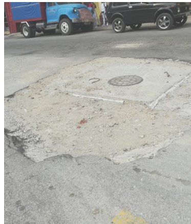
Bache en Calle Monte. Foto: ICLEP
