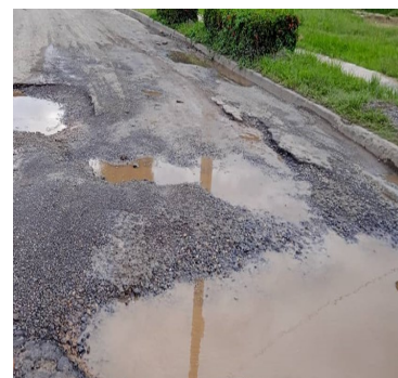
Vial Colón en mal estado: Foto ICLEP
