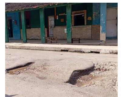
Baches de la calle 98. Foto: ICLEP
