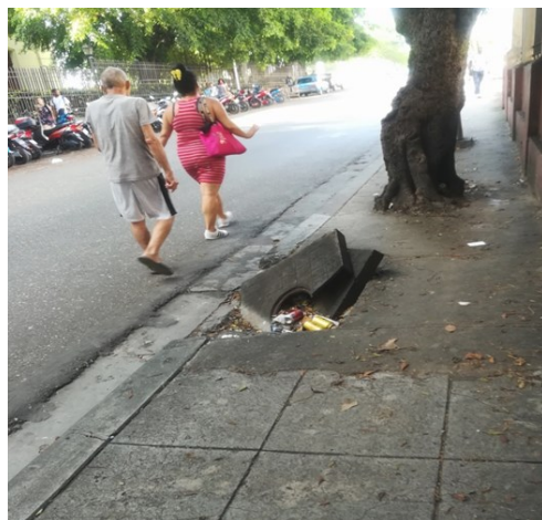
Registro de alcantarilla sin tapa. Foto: ICLEP
