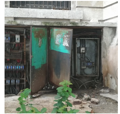
Registro eléctrico destapado, IPU José Martí. Foto: ICLEP
