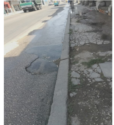
Salidero de agua potable en la Calzada 10 de Octubre entre Pamplona y Madrid, 10 de Octubre. Foto: ICLEP
