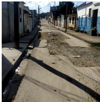
Calle afectada. Foto ICLEP
