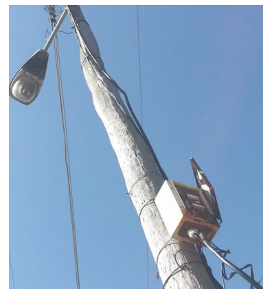
Lámpara deteriorada a la entrada del puente. Foto: ICLEP
