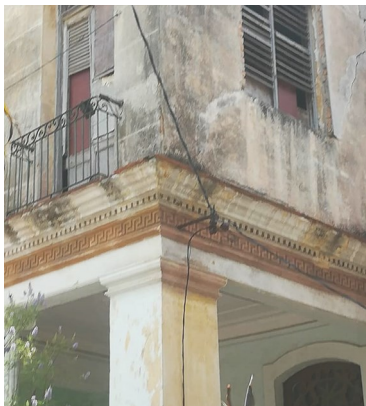
Ventanales rotos. Foto: ICLEP
