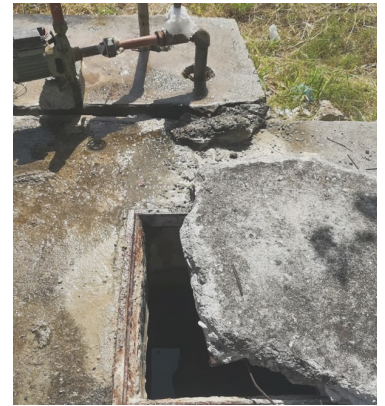
Losa improvisada en la cisterna del edificio 10 236. Foto: ICLEP
