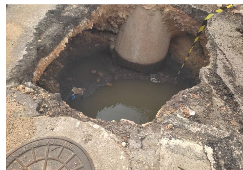
Hueco de la calle 5ta. entre 4 y 6. Foto: ICLEP Paseo y 2.
