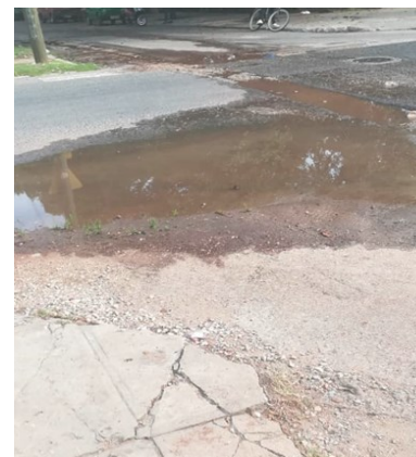
Agua Acumulada en la esquina de H y 21, Vedado, municipio Plaza de la Revolución. Foto: ICLEP
