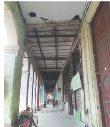
Portal de la calle Reina entre San Nicolás y Manrique, municipio Centro Habana. Foto: ICLEP
