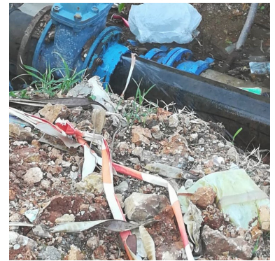
Salidero de agua potable, Avenida Los Cocos. Foto: ICLEP
