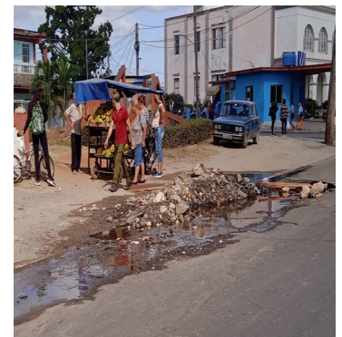
Salidero de agua en la calzada a La Coloma: Foto ICLEP
