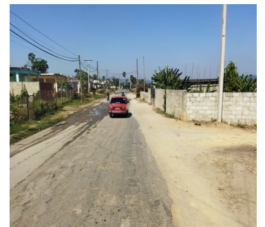
Calle en mal estado: Foto ICLEP
