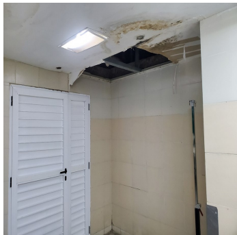
Sala en mal estado en el Hospital Abel Santamaría: Foto ICLEP
