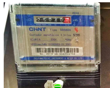
Metro Contador de 220 volts. Foto: ICLEP
