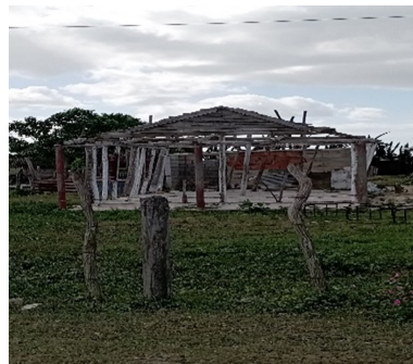
Vivienda damnificada por IAN: Foto ICLEP
