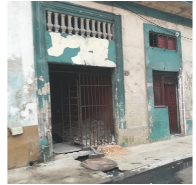
Fosa vertiendo aguas albañales, calle Trocadero. Foto: ICLEP
