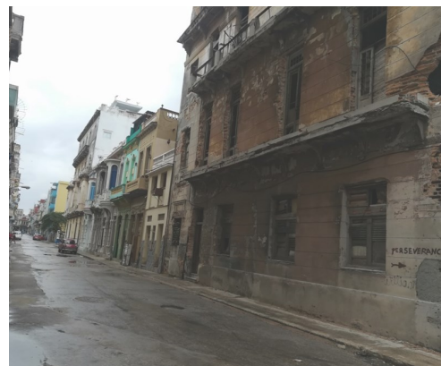
Edificio a punto de desplomarse en la esquina de San Lázaro y Perseverancia, municipio Habana Vieja. Foto: ICLEP
