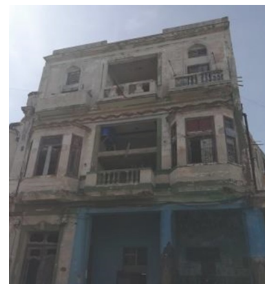
Edificio en peligro de derrumbe en la calle San Lázaro y Galiano. Foto: ICLEP
