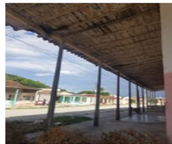
Vivienda en derrumbe. Foto de la Fuente
