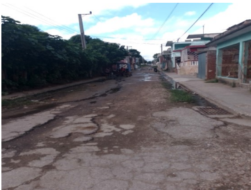
Fosas vertiendo agua a la calle. Foto ICLEP
