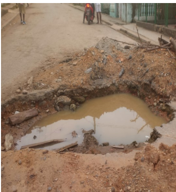
Agua acumulada. Foto: ICLEP
