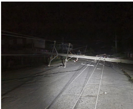
Tendido eléctrico de la carretera a Viñales: Foto ICLEP
