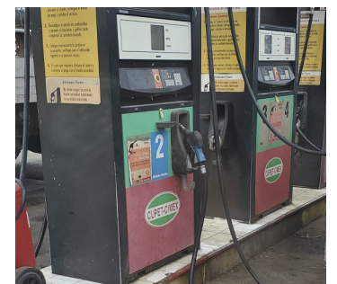
Bomba de combustible. Foto: ICLEP
