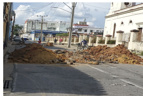
Reparación hidráulica inconclusa: Foto ICLEP
