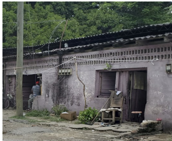
Viviendas afectadas: Foto ICLEP
