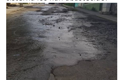
Salidero de agua. Foto: ICLEP
