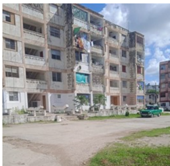
Edificio afectado. Foto ICLEP
