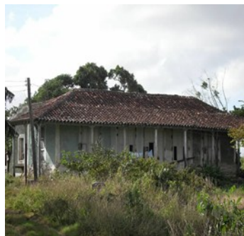
Casa afectada . Foto ICLEP
