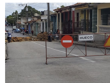
Hueco en la calle Retiro: Foto ICLEP
