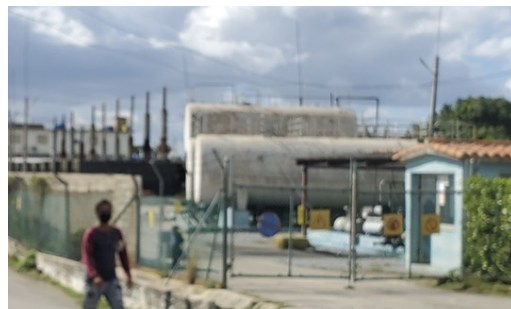
Grupo electrógeno: Foto ICLEP
