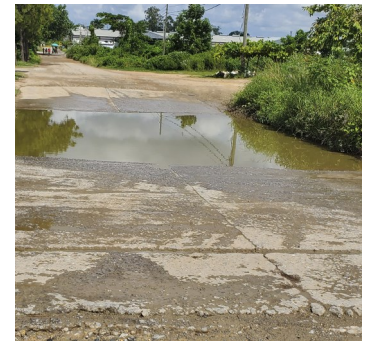
Salidero de agua. Foto: ICLEP
