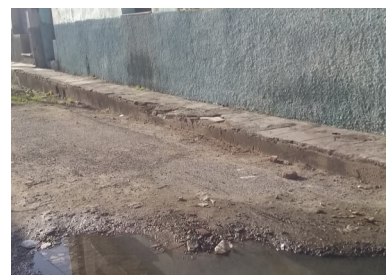
Vía en mal estado. Foto ICLEP
