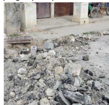
Derrumbe del balcón. Foto: ICLEP
