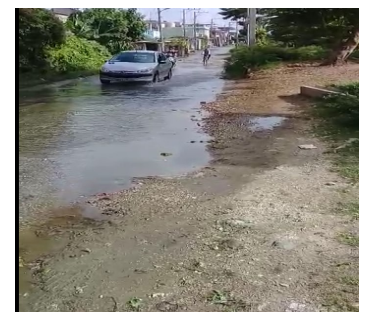
Salidero de agua. Foto ICLEP
