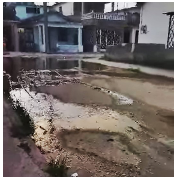
Salidero de aguas albañales en avenida 105. Foto: ICLEP
