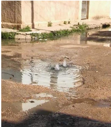
Registro sanitario de la calle 100. Foto: ICLEP
