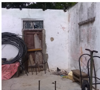
Techo colapsado. Foto ICLEP
