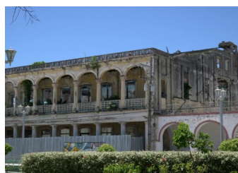
Edificio en Deterioro. Foto ICLEP.
