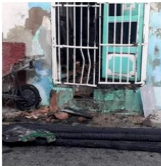
Casa afectada. Foto ICLEP
