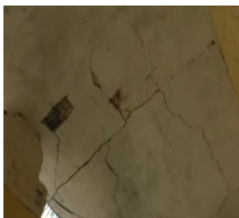
Grietas del techo Foto ICLEP
