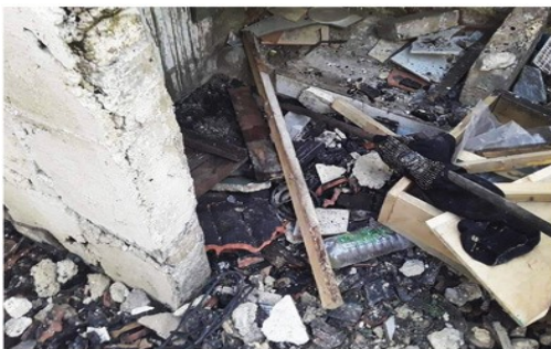
Una de las casas afectadas. Foto: ICLEP
