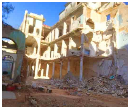
Derrumbe en Centro Habana. Foto: ICLEP
