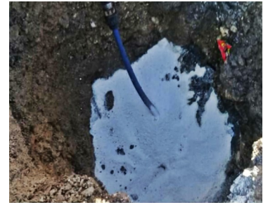
Salidero de agua. Foto: ICLEP
