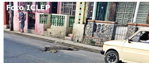
Hueco en la vía de acceso.
