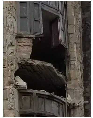
El derrumbe parcial ocurrió en las secciones dos y tres del edificio (Foto ICLEP).
