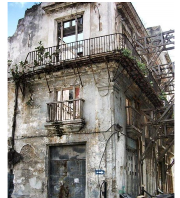
El edificio, a punto de derrumbarse, hace varios años tiene orden de demolición (Foto ICLEP).
