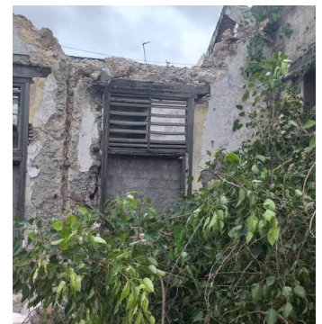
Derrumbe. Foto: ICLEP
