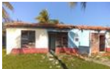
Cabañas en mal estado
