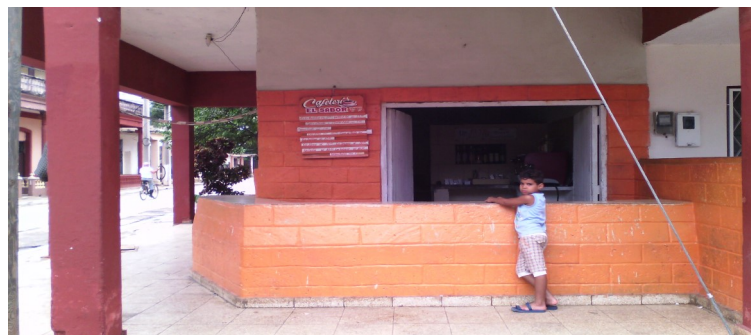
Cafetería "El Sabor" conocida como El Guapo, se encuentra afectada
