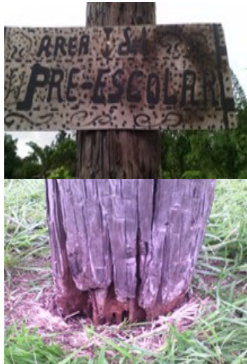
La imagen superior, muestra un cartel colgado del propio poste donde señala el área. Debajo se muestra en las condiciones que se encuentra el mismo.
